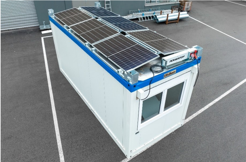
Abbildung 7: Ausstattung eines Baucontainers mit mobilen PV-Modulen zur Erzeugung von Strom auf der Baustelle © Hartl Energy GmbH
