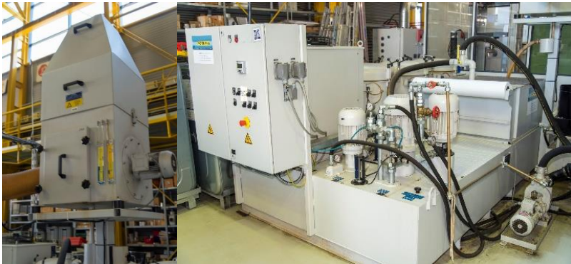
Abbildung 16: Periphere Anlagen des Referenzsystems (links: Abluft, rechts: KSS-Filtration) 73
