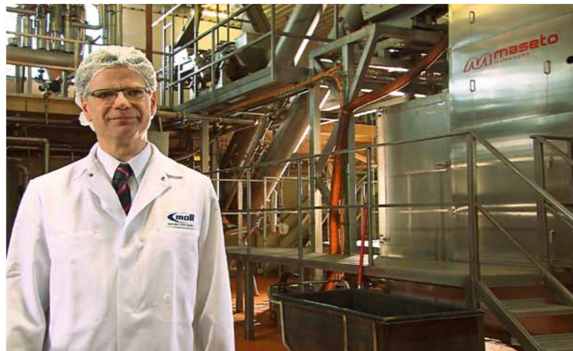
Geschäftsführer Dr. Armin Seitz vor der neuen Blanchieranlage der Moll Marzipan GmbH
